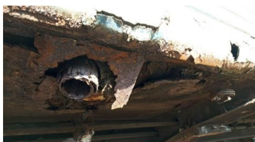
Рис. 6. Корозійні пошкодження підлоги кузова
