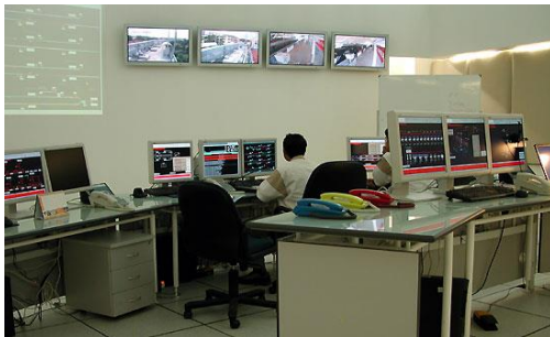
Рис. 3. Современная диспетчерская, в которой осуществляется контроль работы монорельсовой системы в Kuala Lumpur 11 .
